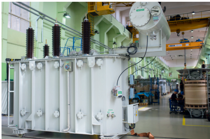
Im Januar 2016 begann die Integration bei ZREW Transformatory S.A.
